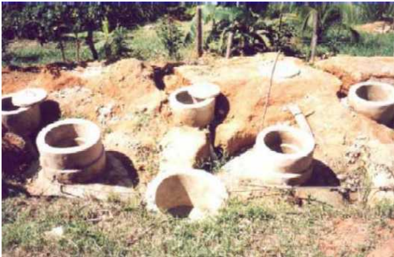
Construção dos biodigestores "PE" em uma das propriedades, já em fase de acabamento
